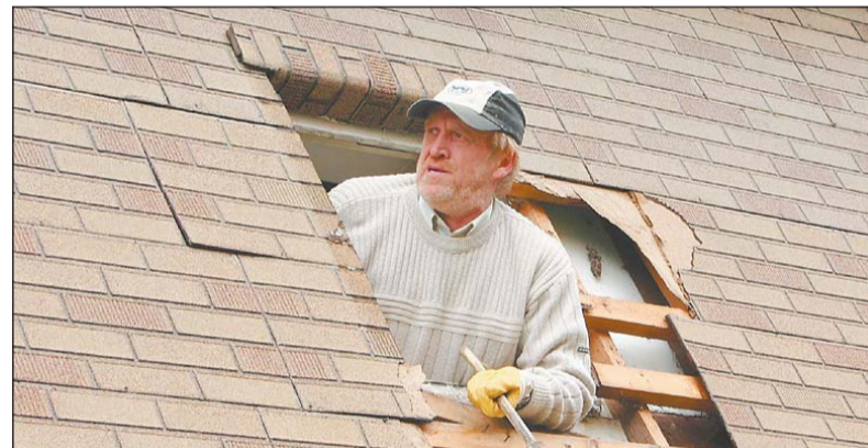
Der Durchbruch ist geschafft: Friedhelm Möller hat sich von innen nach außen vorgearbeitet.
