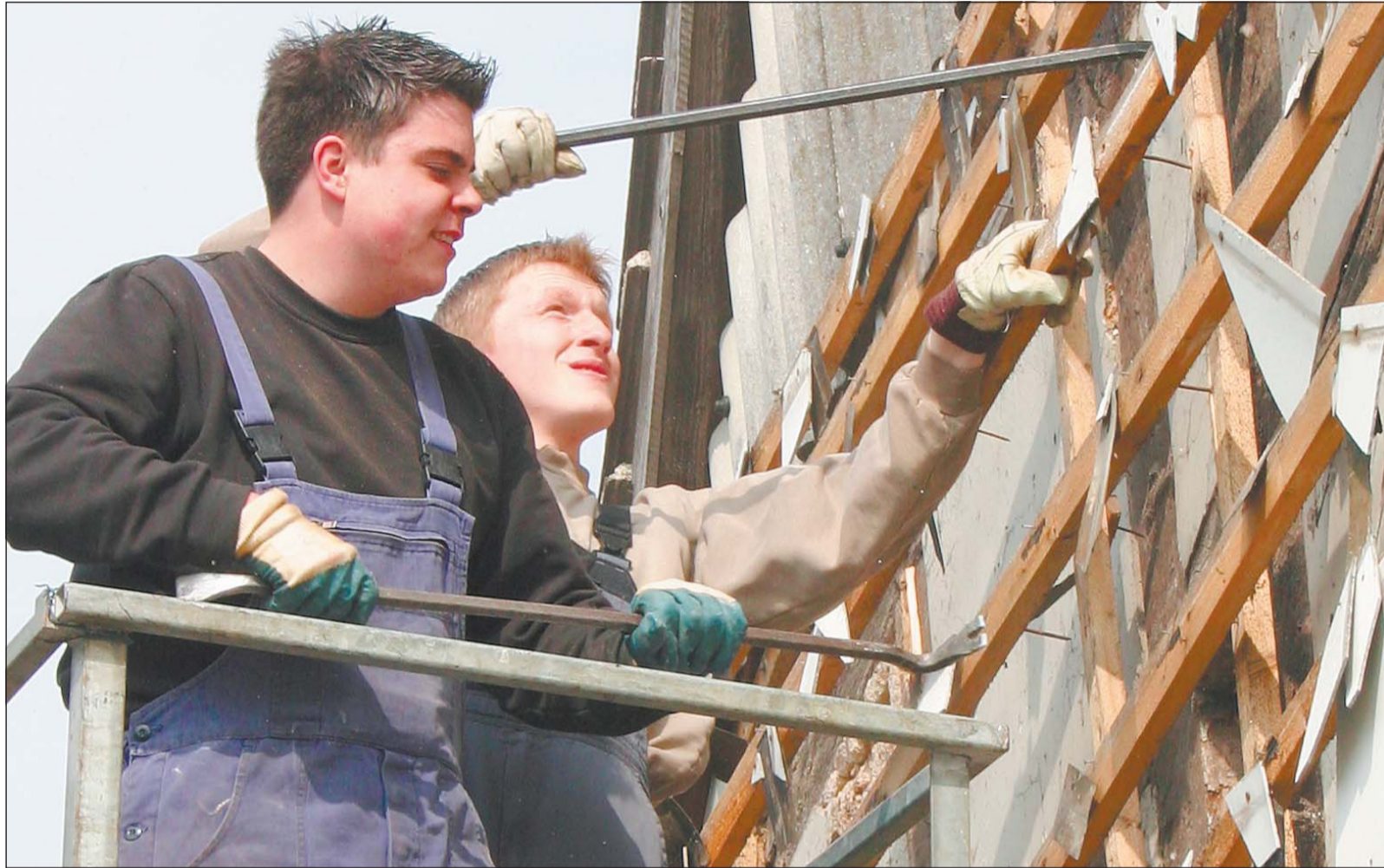
Mit Brecheisen lösen Michael Peine (hinten) und Denis Bischof die Außenverkleidung des Hauses im Ortszentrum. Zahlreiche junge Dorfbewohner sind am Samstag mit ein. Am kommenden Samstag geht es weiter. Fotos: Jürgen Köster
